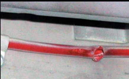
Firetrace tubing “burst”
